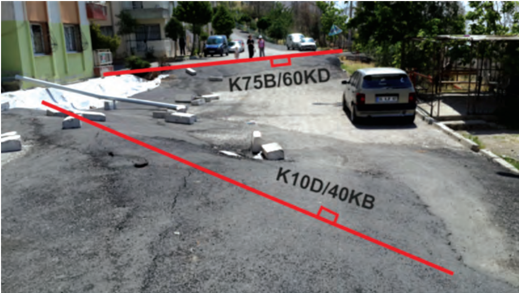
Şekil 3. Çınar apartmanının kuzey cephesinde heyelan nedeniyle oluşan deplasmanlar.
