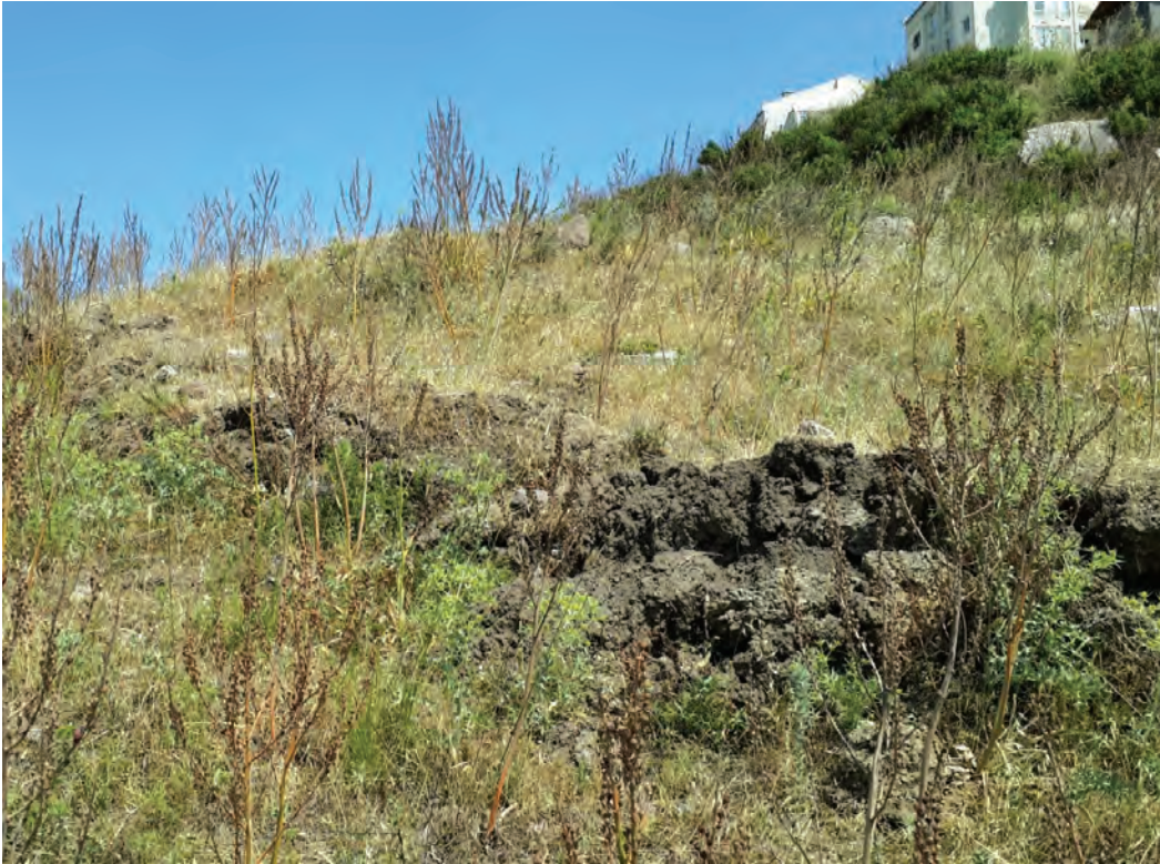
Şekil 17. Heyelanın topuk bölgesinde meydana gelen deformasyonlar (kuzeybatıdan güneydoğuya doğru fotoğraf çekimi yapılmıştır).
