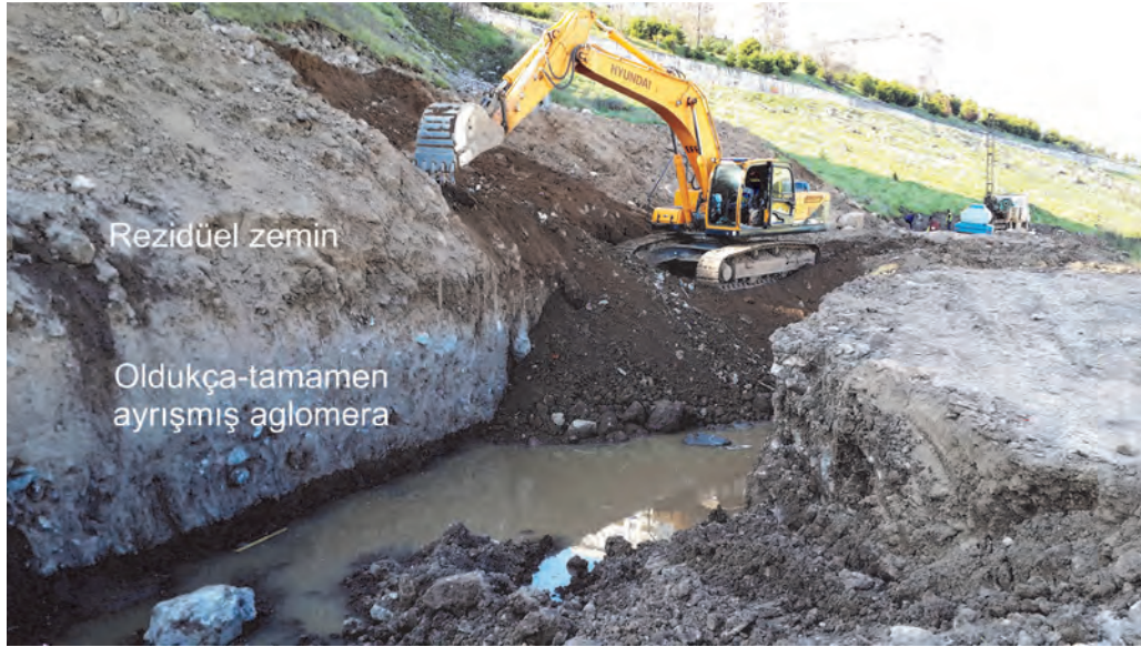
Şekil 12. Okul binasıyla F_1 -fayı arasında yer alan kazı şevinde açığa çıkan, zayıf kaya-sert zemin arasında yer alan ayrılmış aglomeralardaki geçiş zonu (yeraltı suyu yüzeye yakın konumda).
